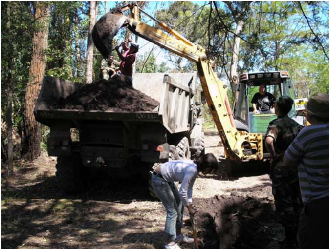
Figura 16. Tareas de excavación con pala mecánica, con retiro de sedimento fuera del área de trabajo.
