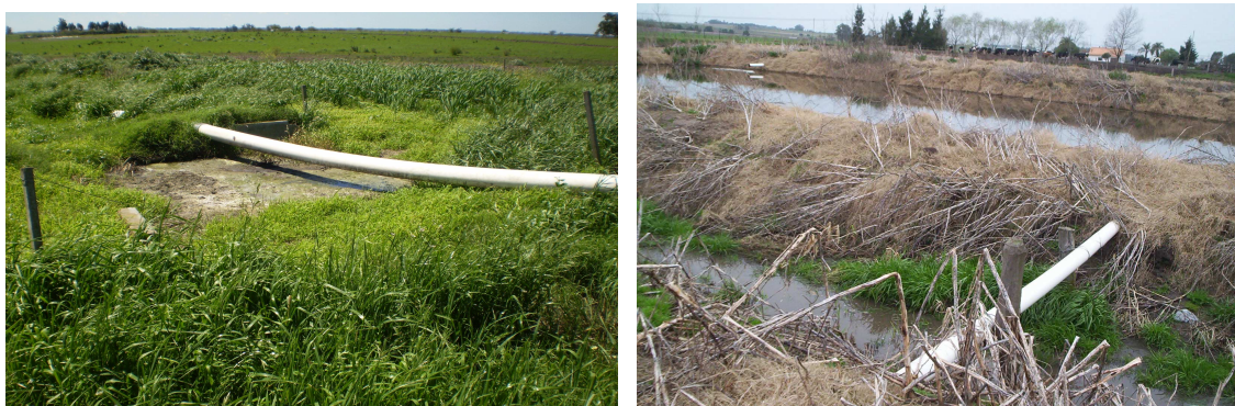
Figura 8: Tuberías sobre unidades (izquierda), tuberías sobre cañadas (derecha)
